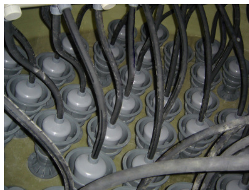
Die Abbildung zeigt mehrere parallel eingebaute Ring-Jet Module in einem Wäscherturm
